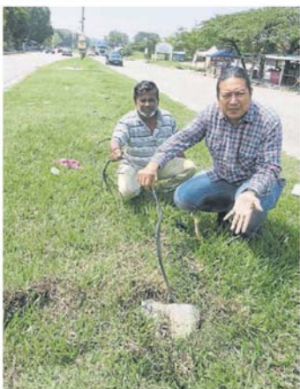
■无拉港再也主要道路其中一个街灯断裂已久，柱子根部甚至已长草，右起为莫哈末阿里和古西。
